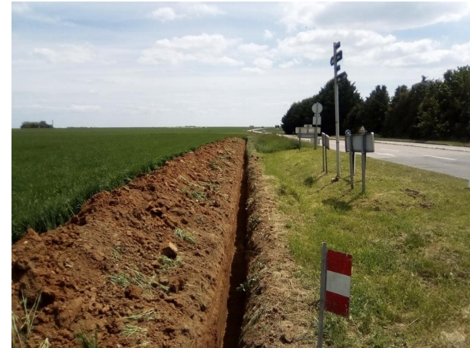
Photo 3 : tranchée pour le passage de réseau électrique HTA à partir d'une pelle
